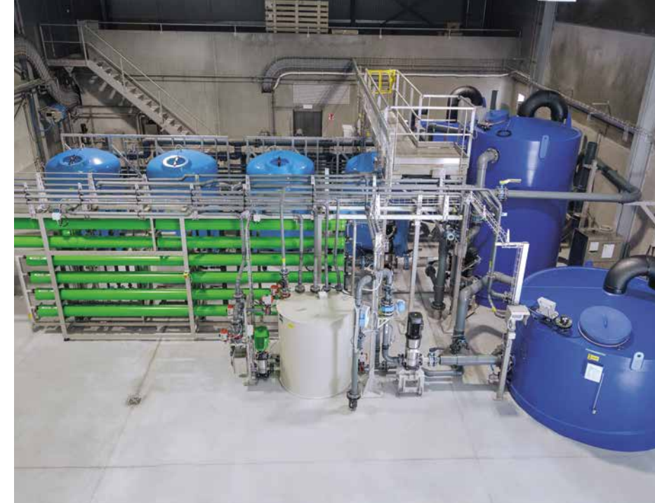
Het systeem bij VEOS voor waterbehandeling én hergebruik van energie uit het gezuiverde water.
